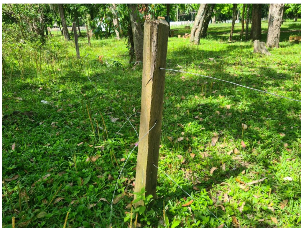
Fig. 6: cerca com sinais de depredação. 25/out/2022
